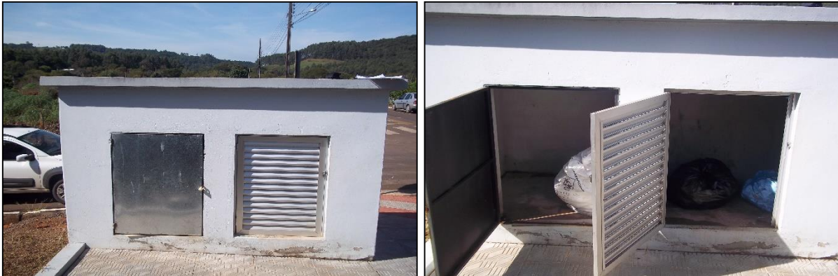
Figura 103 – Local de acondicionamento dos resíduos do serviço da saúde em Iraceminha
