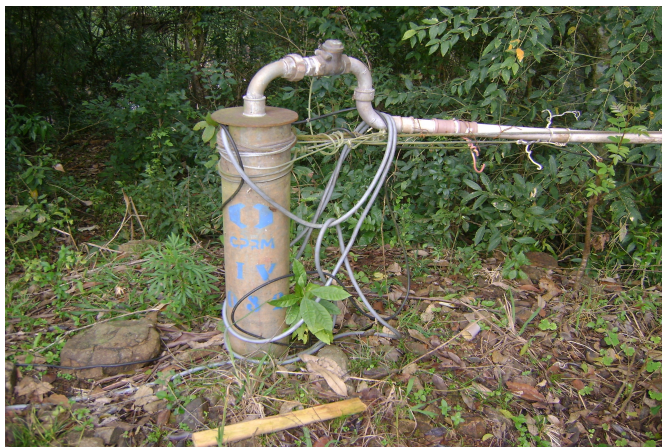
Figura 4.4:Poço profundo Flor do Sertão 2
