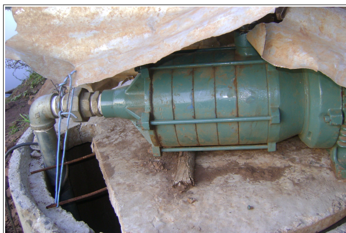
Figura 4.13:Captação da água , para a ETA no rio Sargento.
