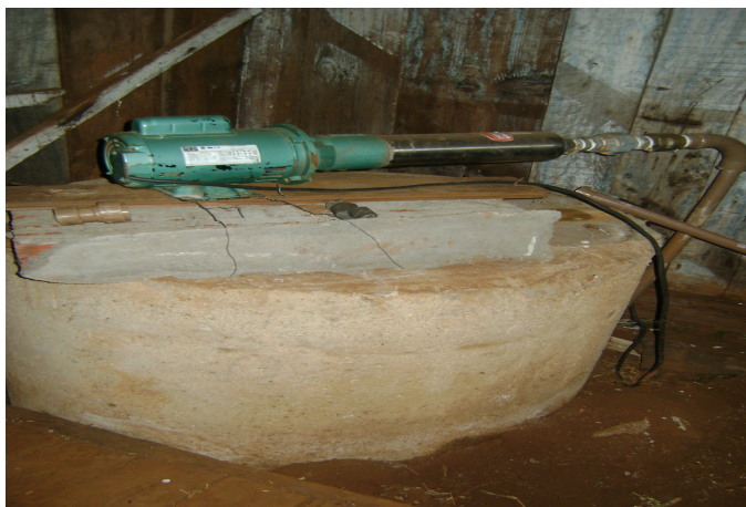
Figura 4.21: Captação da Água na Fonte Superficial de Linha Sarandi
