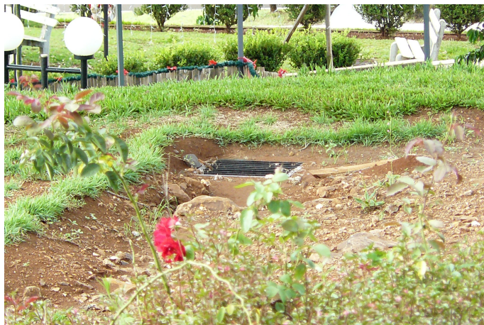
Figura 7.6: Boca de lobo em local inadequado.
