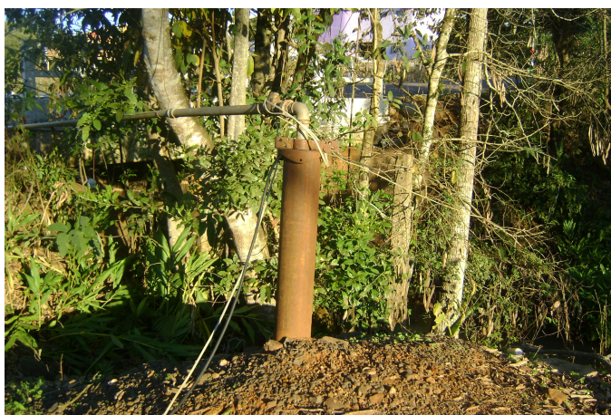
Figura 4.3: Poço profundo Flor do Sertão 1
