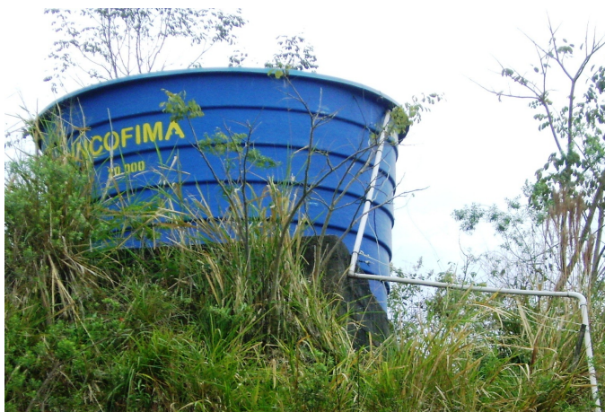
Figura 4.6:Reservatórios 1 situado no poço profundo Flor do Sertão 1.
