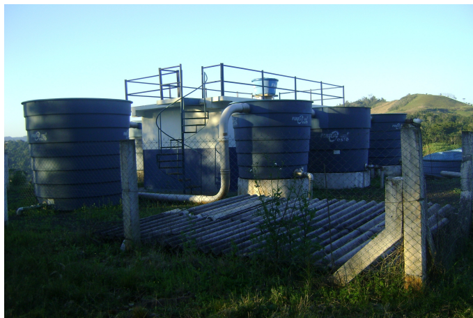
Figura 4.9: Detalhe da estação de tratamento de Flor do Sertão
