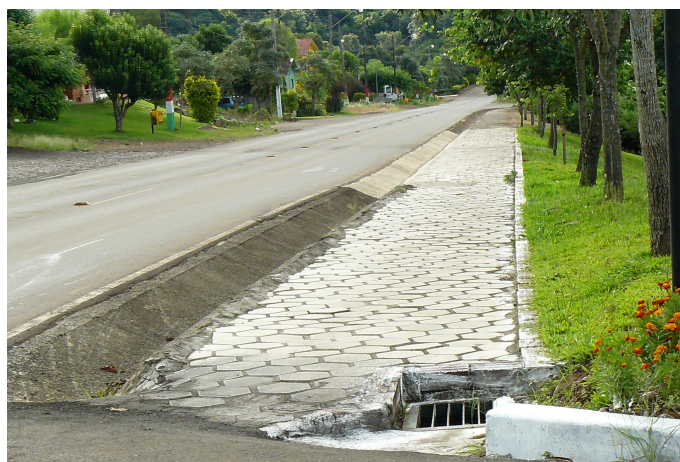
Figura 7.7: Boca de lobo e drenagem pluvial.
