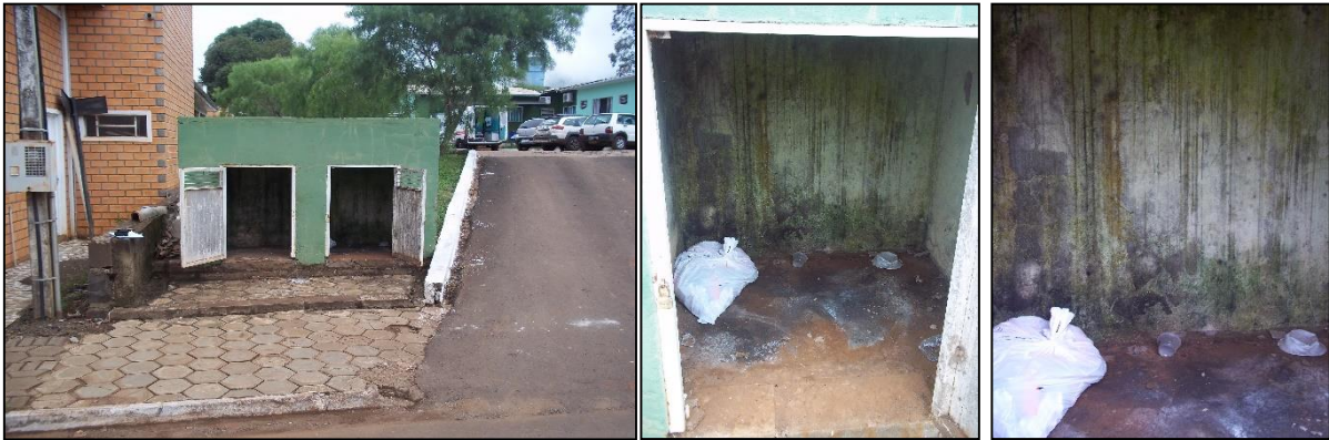
Figura 114 – Local de acondicionamento dos resíduos do serviço da saúde em Santa Terezinha do Progresso
