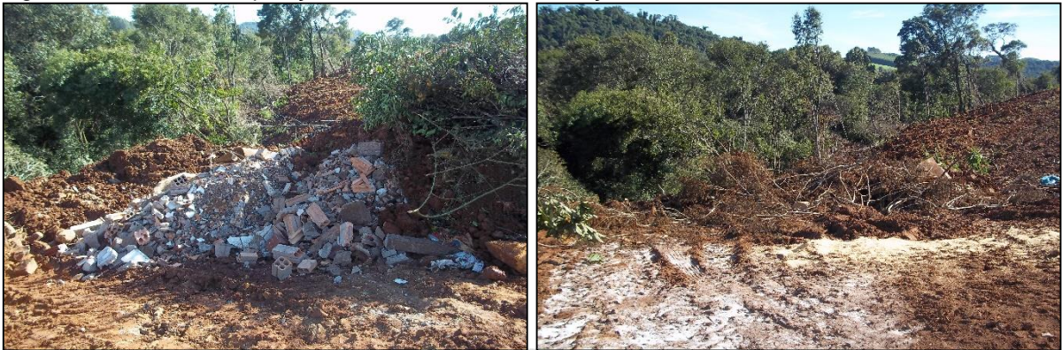
Figura 89 – Local de disposição dos resíduos da construção civil em Modelo
